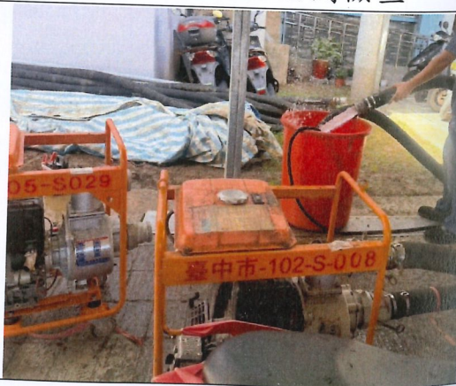
102-S008-08-抽水機運轉中
