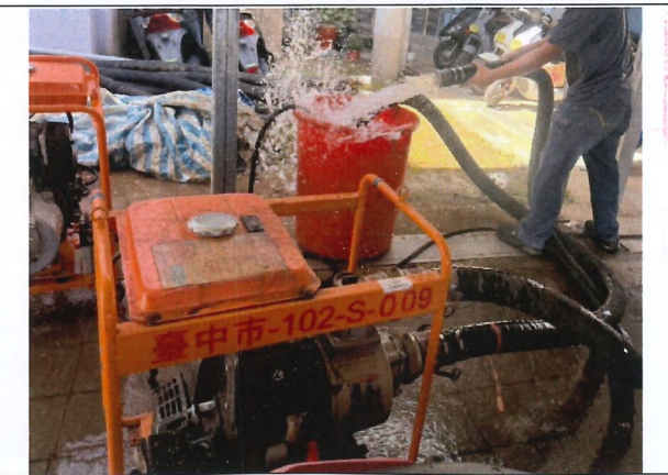
102-S009-08-抽水機運轉中
