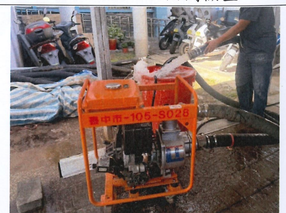
105-S028-08-抽水機運轉中
