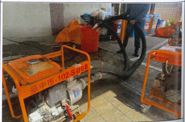
102-S008-08-抽水機運轉中
