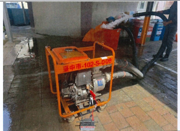
102-S009-08-抽水機運轉中
