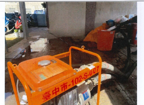
102-S007-08-抽水機運轉中
