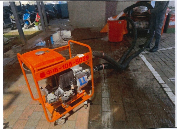
105-S029-08-抽水機運轉中
