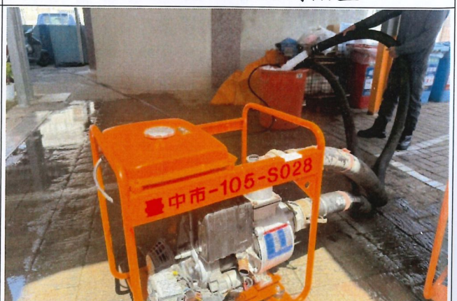
105-S028-08-抽水機運轉中
